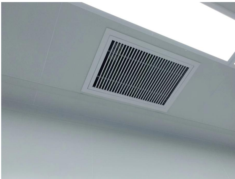
图3-5 机房内通风口
