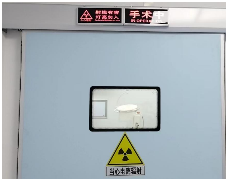
图3-3 DSA机房大门警示灯
